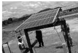
Finanziert aus Mitteln des Grünen Stroms: PV-Anlage in Bismark-Grund für die Stromversorgung des Schulzentrums
